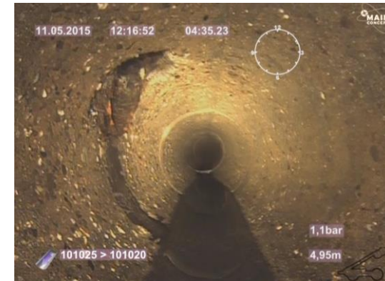
Haltung 101025 -> 101020 – Stutzen nicht fachgerecht ausgeführt
